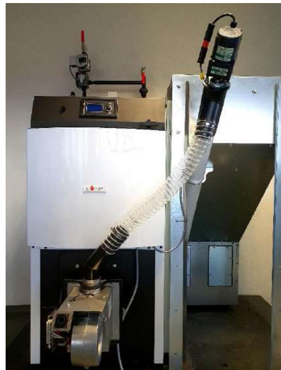
Orienter le tube vers le silo.
