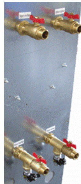
Vannes au dos du générateur
