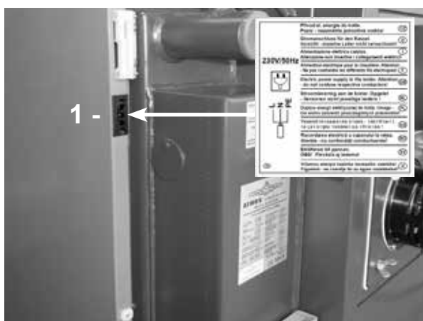
Connecteur sur la chaudière hotte droit
